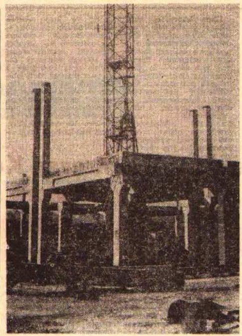
Trwa robota budowa hali nr 12. Mimo niesprzyjającej pogody prace posuwają się szybko do przodu.
